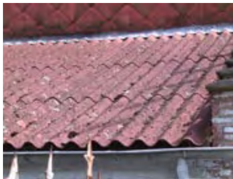
Plaques ondulées de toiture en amiante-ciment
